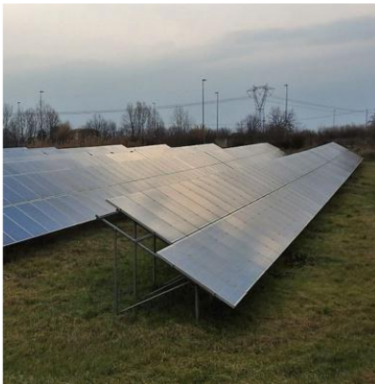
Un impianto privato in un campo della Bassa Romagna. A lato, Antonio Mastroluca, imprenditore di Russi con pannelli installati su di una casa
